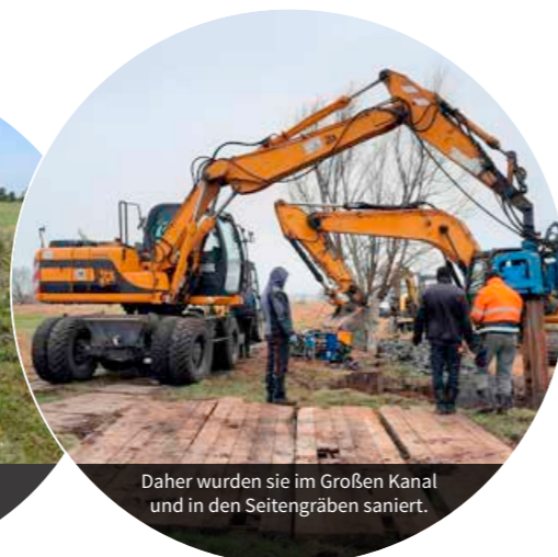
Die Stauanlagen waren marode und nicht mehr funktionstüchtig.
